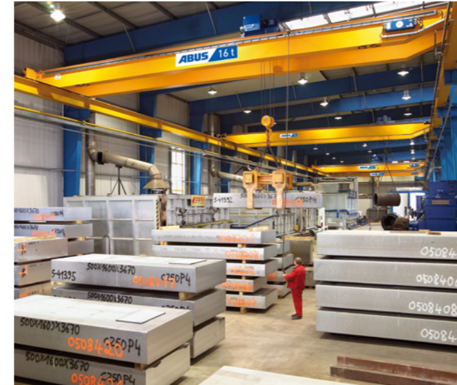
Dubbelrail-katten type D op dubbelligger loopkranen.
